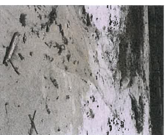
Photographie de traces d'érosion en provenance de la route (source : Suez Consulting, 2020)
